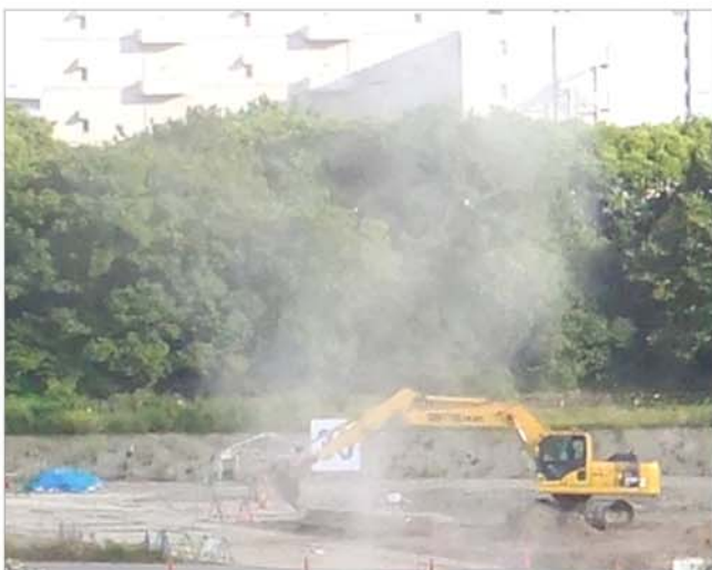
対策工事は、汚染された土を舞いあげています。
