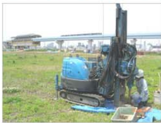
不十分だったボーリング調査=08年の豊洲視察は「自然由来」なのでそのまま残すとしています。
