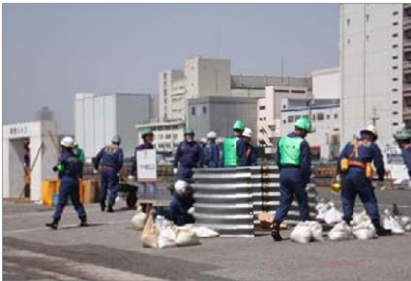
マンホールを金属で囲み吹き出る水を防ぐ対策
