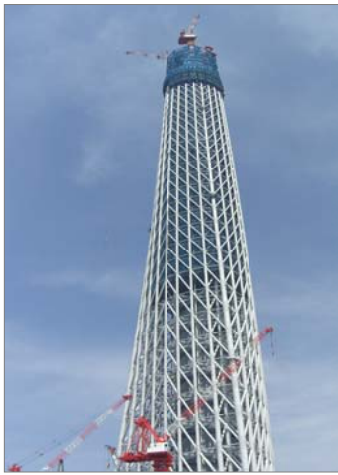
地デジ波を送信する、建設中の東京スカイツリー 5月3日撮影
