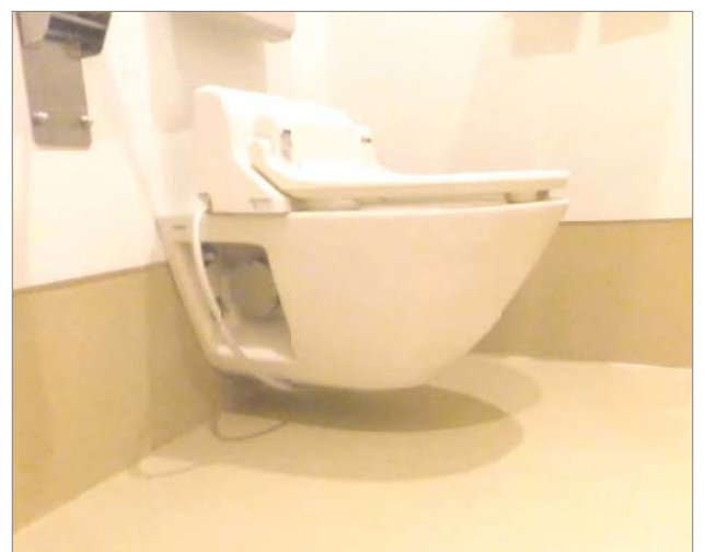
便器の下は掃除がしやすいように浮いてます。
