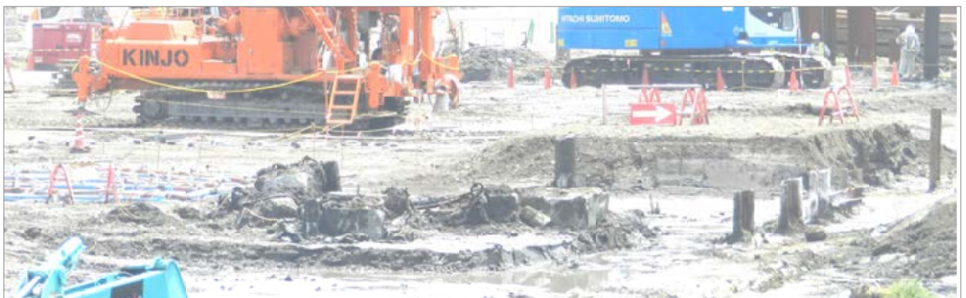
東京ガス工場建物で使われていた18000本の杭や建物基礎などのコンクリートの一部＝5街区
