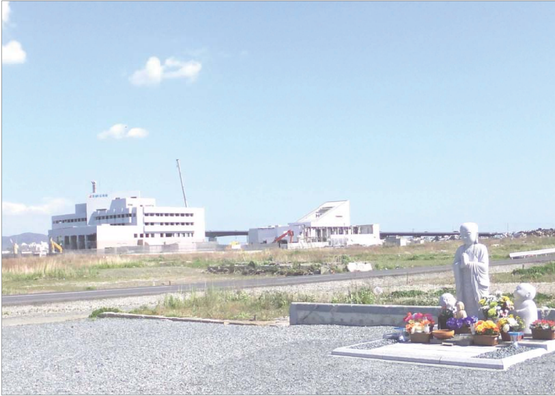
取り壊し中の 石巻市立病院（左）と石巻文化センター（中）＝門脇小学校前から
