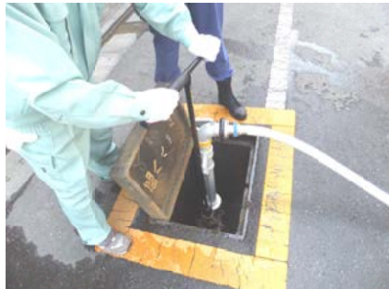
消火栓から放水できるスタンドパイプ
