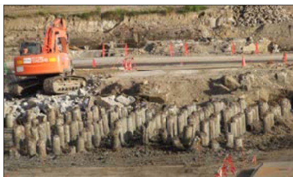
豊洲市場予定地で掘り出された元東京ガス工場建物の基礎杭。地中に1万8000本も埋まっています。 12/9/17 志村たかよし議員撮影。
