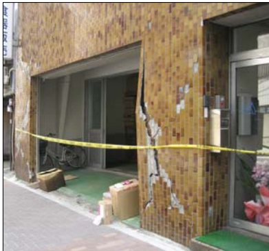
地震で破損した建物
